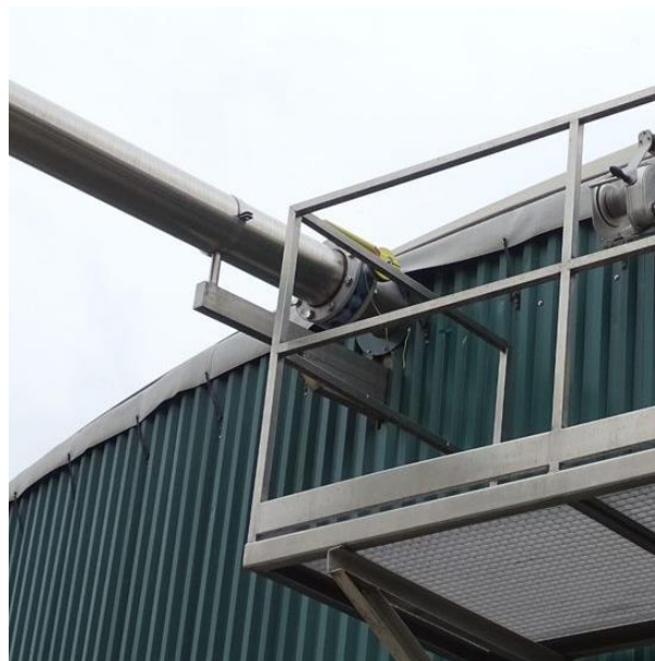
Figure 48: Overhead piping Source: Principi di Porcia e Brugnera
