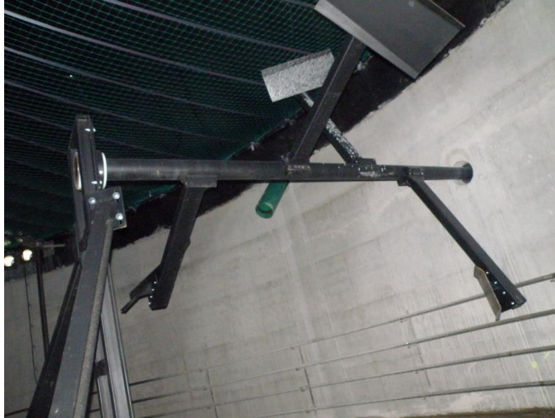
Figure 18: Mixer inside the digester Source: Principi di Porcia e Brugnera
