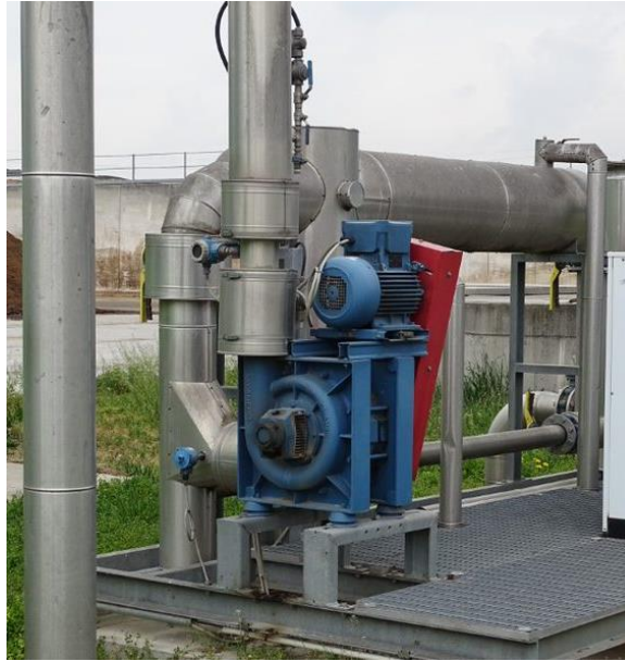
Figure 49: Biogas blower Source: Principi di Porcia e Brugnera
