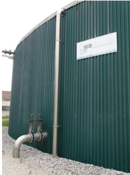
Figure 47: Biogas intake pipes Source: Principi di Porcia e Brugnera
